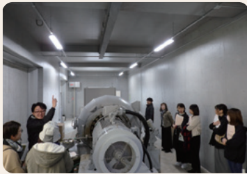
三八支部、上十三支部 （合同開催） 指久保ダム・小水力発電所 の視察
